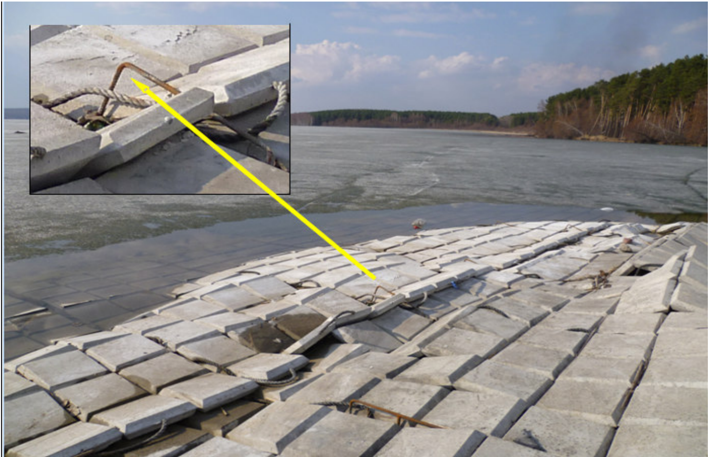
Фото 1. Разрушение покрытия из ГБ-матов под воздействием льда
